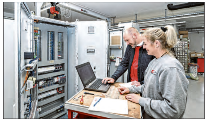
Der Schaltschrankbau ist keine Männerdomäne.
